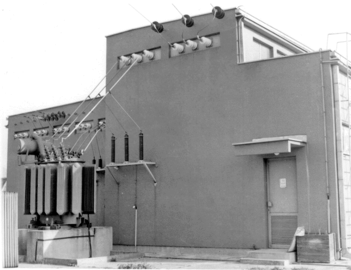
Rekonstrukcija tj. izgradnja nove proširene TS - 35/10 kV u Babušnici 1977 godine čime su stvoreni uslovi za stabilno napajanje električnom energijom svih 54 naselja u opštini
